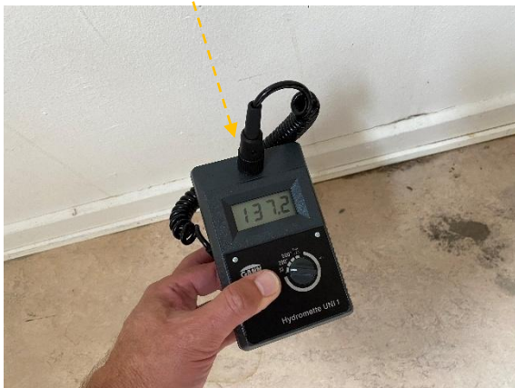
#23 Gulv måles meget fugtigt.
