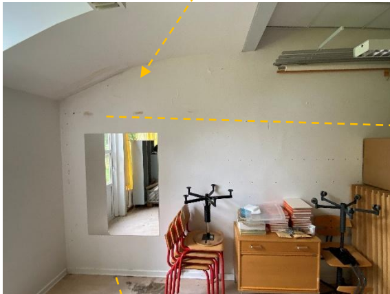
#21 Der ses saltudfældninger samt puds- og malingsafskalninger på væggen mod biblioteket.
