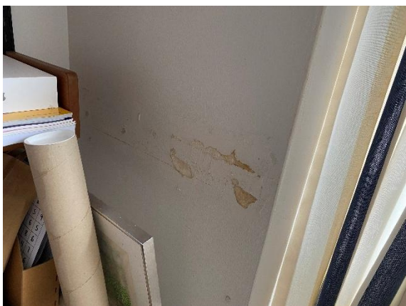
#39 Der ses misfarvninger på ydervæggen.
