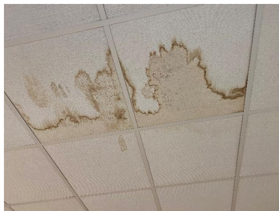
#18 Prøve P/T19 er udtaget fra misfarvet loftplade.
