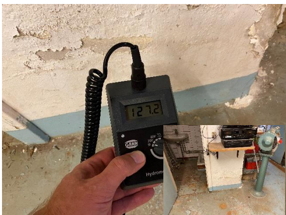
#53 Vægge i kælderen måles fugtige.
