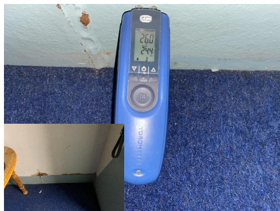
#54 Lette vægge i kælderen måles våde.
