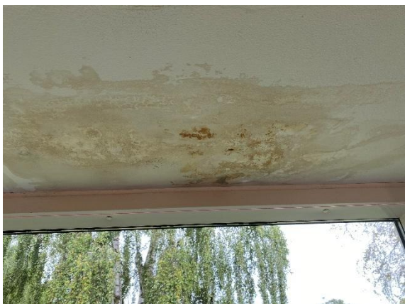
#11 Prøve P/T16 og P/T17 er udtaget fra misfarvninger på lofter.
