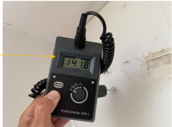
#22 Væg måles meget fugtig. Prøve P/T21 er udtaget fra misfarvninger på væg.
