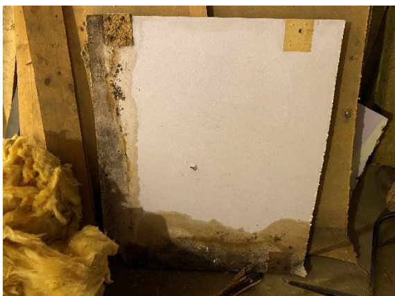
#51 Der opbevares effekter i kælderen med misfarvninger og synlige fugtskader.
