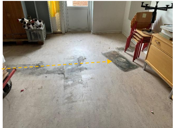
#20 Der ses misfarvninger på gulvbelægningen. Prøve P/T20 er udtaget fra misfarvning.
