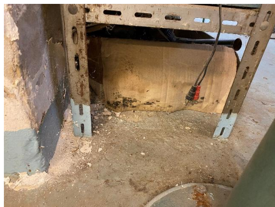
#52 Der opbevares effekter i kælderen med misfarvninger og synlige fugtskader.
