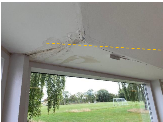
#13 Bibliotek. Der ses skader på loft. Prøve P/T18 er udtaget fra misfarvet område.
