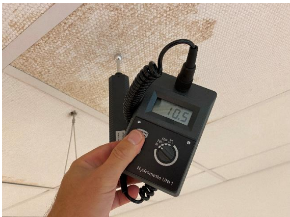
#35 Loftplade måles tør. Prøve P/T23 er udtaget fra misfarvning på loftplade.
