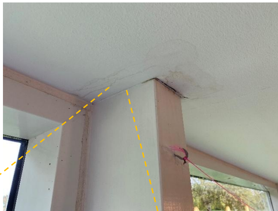
#8 Der ses flere steder skjolder på loftet.
