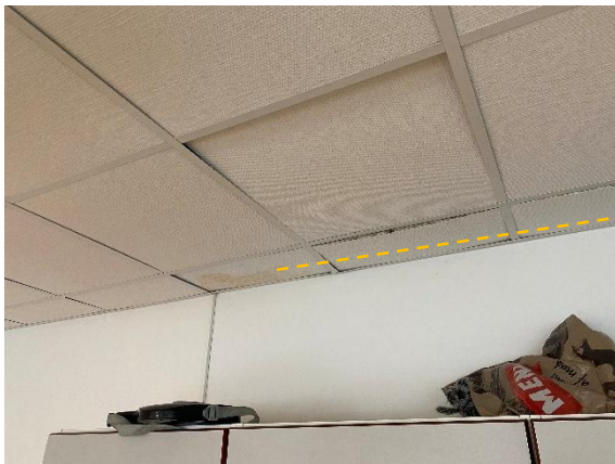
#5 Der ses skjolder på loftplader. Prøve P/T15 er udtaget fra skjolder.
